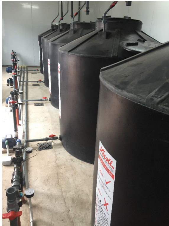
Figura N° 12: Tanques de fertirriego con tuberías independientes para cada tratamiento.
